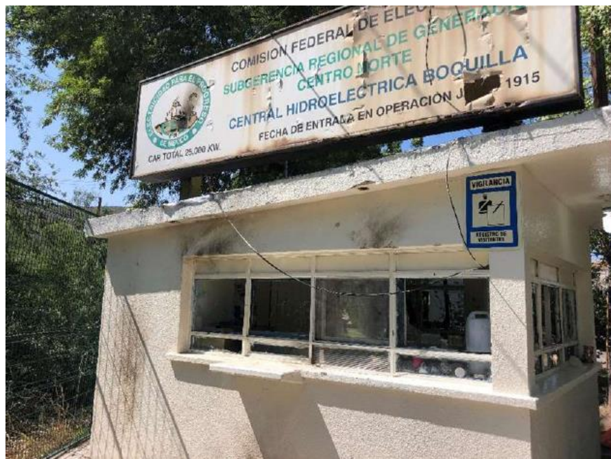
Daños a caseta de vigilancia de control de acceso a la Central.
