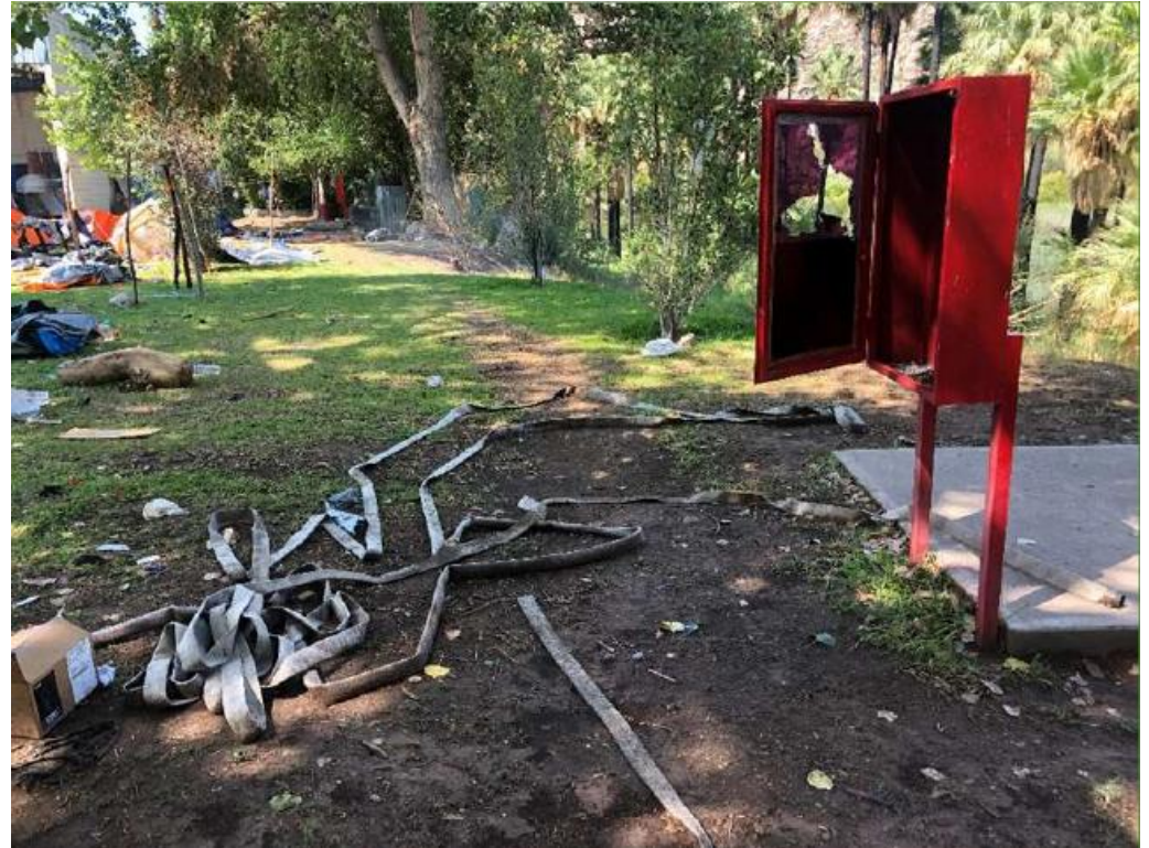
Destrozos en redes de hidrantes del sistema contra incendio de la Central.
