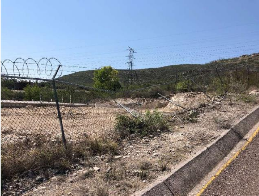
Daños en cerca perimetral de los predios de la Central.
