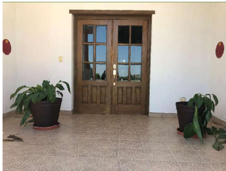
Daños puerta de acceso a la Superintendencia de la Central.
