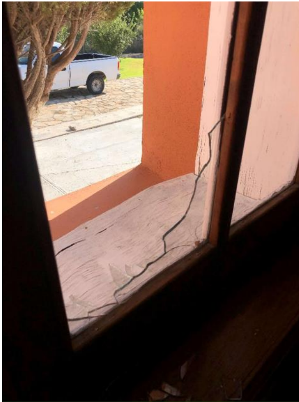
Daños en oficinas administrativas de la Central.
